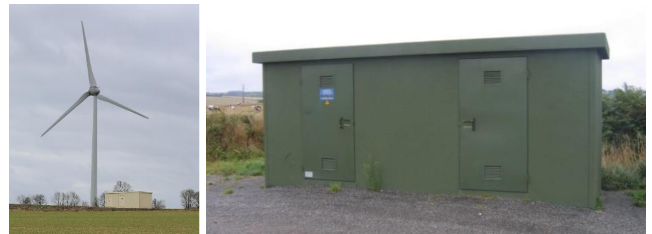
Photo 5 : Exemples de poste de livraison électrique
